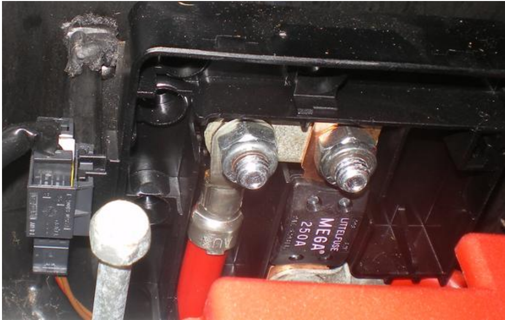
Figure 6: Fusible batterie 12V A400
